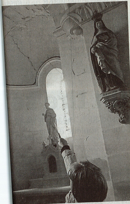
Entre les fissures sur les voûtes de l'église.
